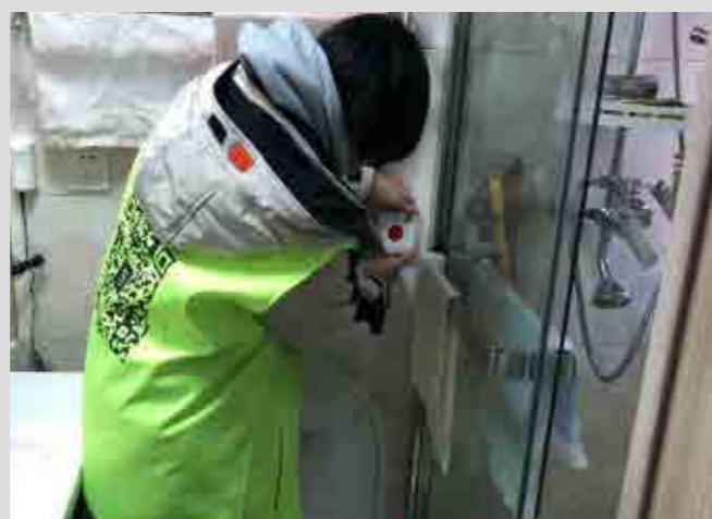
卫生间紧急呼叫器
