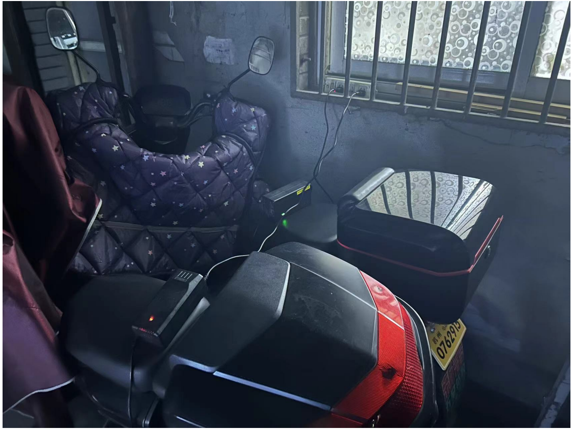
4月23日晚 天水街道延安新村体育场路301幢4单元电动车飞线充电
